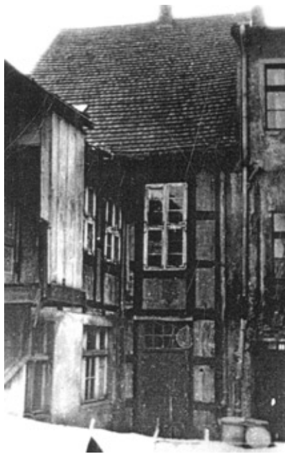
Zaplecze Apteki w Darłowie od strony podwórza w oczekiwaniu na remont (stan z 1963 r.)
